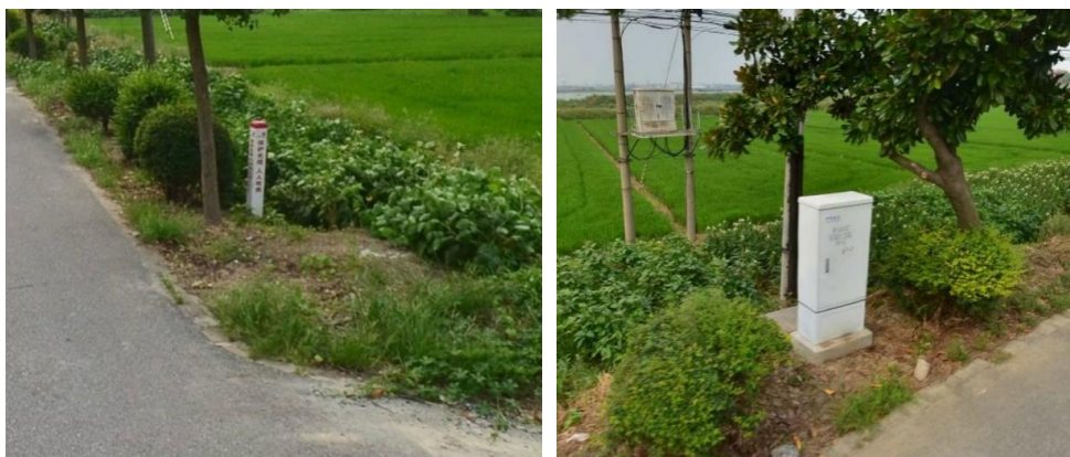
莲金支路现状通信管线
