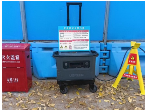
现场使用移动电源照片
