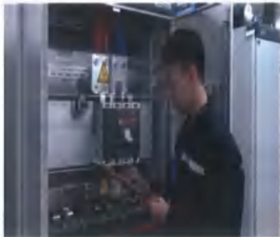
汇聚机房设备检查
