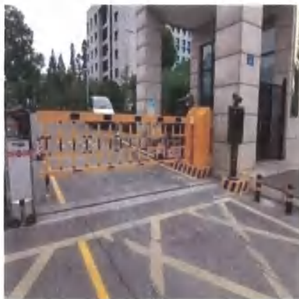
道闸线路老化
