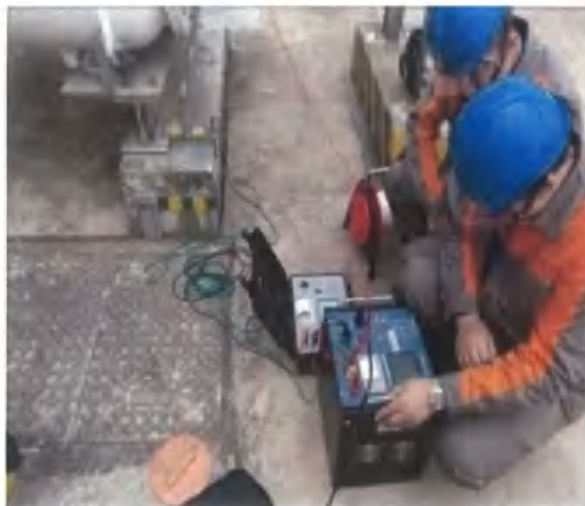
摄像机接地检查
