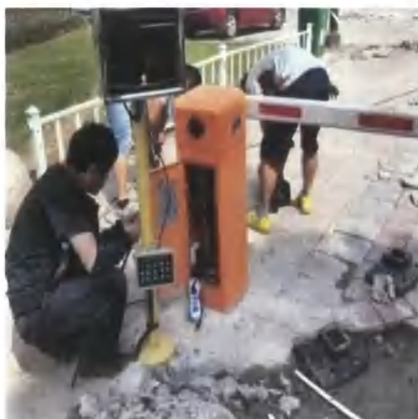
道闸年度检修
